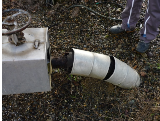
Figure 3 : Photographie de l'état de vétusté du réseau incendie
